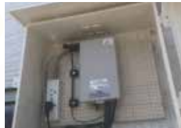
屋外ボックス AC より
